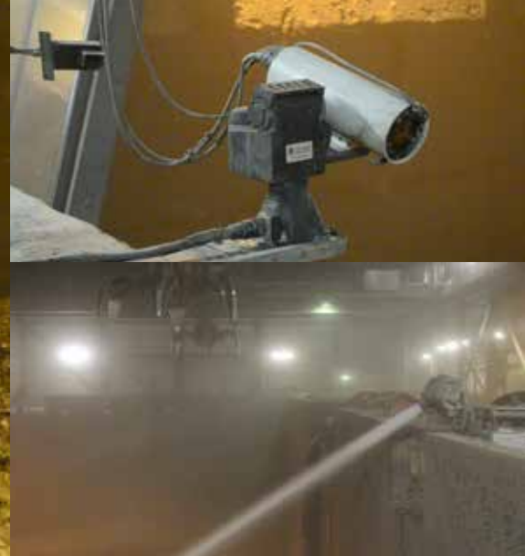
Un factor fundamental para extinguir un incendio es tener una respuesta precoz. Esto puede conseguirse con las cámaras FLIR. Jönköping Energi puede hasta extinguir un incendio antes de empezar.
