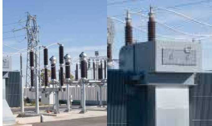
Un LTC desempeña un papel crucial en el funcionamiento de un transformador.
