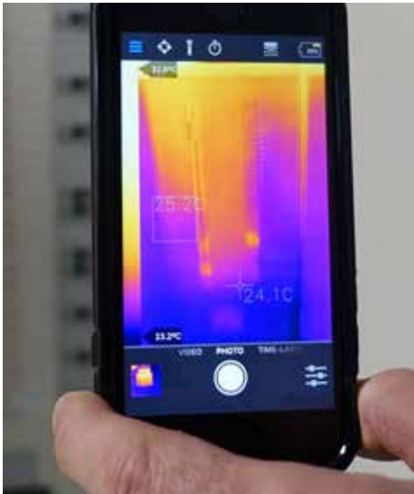
La recirculación de aire caliente queda claramente visible al visionar la parte frontal de los bastidores con la FLIR ONE Pro.
