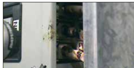
Figura 4. La imagen de comparativa visual muestra la carbonización del aislante de los conductores en el área del fallo térmico.
