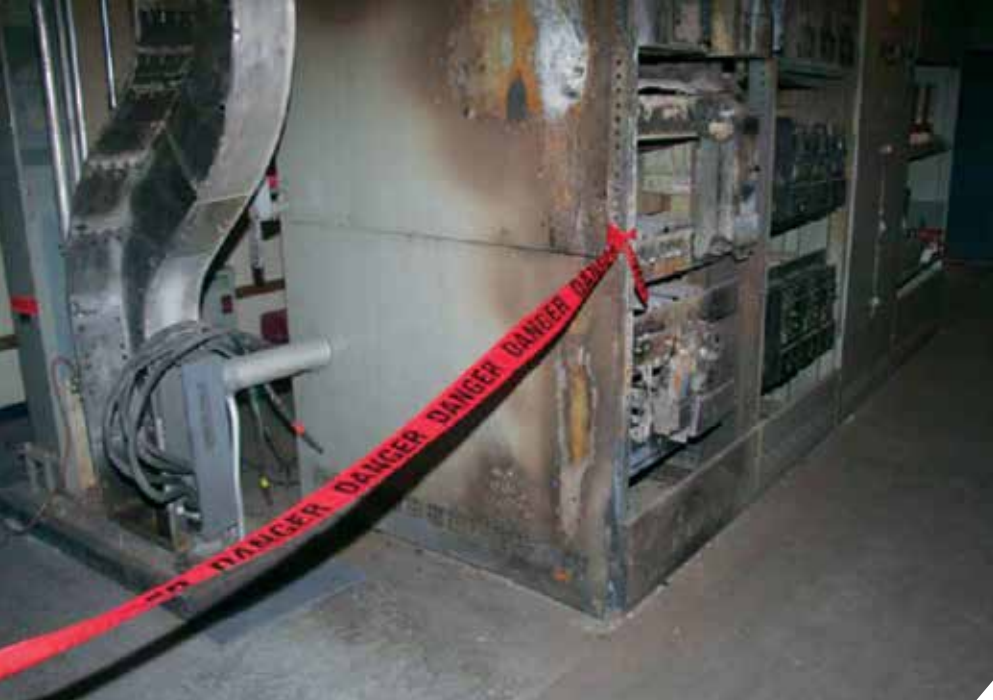
Figura 2. Incendio en conmutadores que provocó daños por 2,3 millones de euros. Esta instalación declinó una oferta de sondeo de IR de un termógrafo de CNA unos meses antes de que se produjera el incendio.
