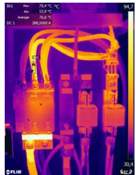
Imagen térmica del sector eléctrico para diagnosticar un contactor con contactos defectuosos.
